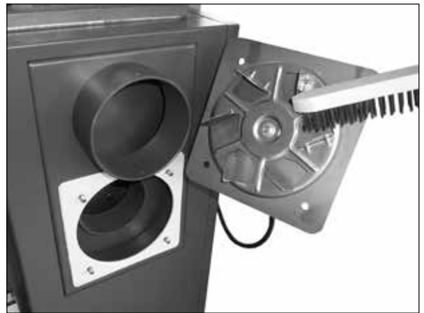
Die Reinigung des Umlaufrad und die Kontrolle des Schaufels bei Saugzugventilator
