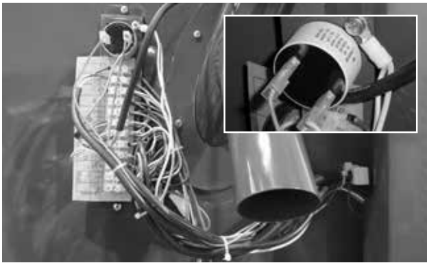
Elektroinstallation des Kessels unter dem vorderen Gehäuse. Anordnung des Anlaufkondensators (1 \mu F) für den Abluftlüfter (außer PX10).
